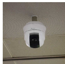
360度可動式ドーム型カメラ （コンコース）
