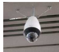
360度可動式ドーム型カメラ （ホーム）
