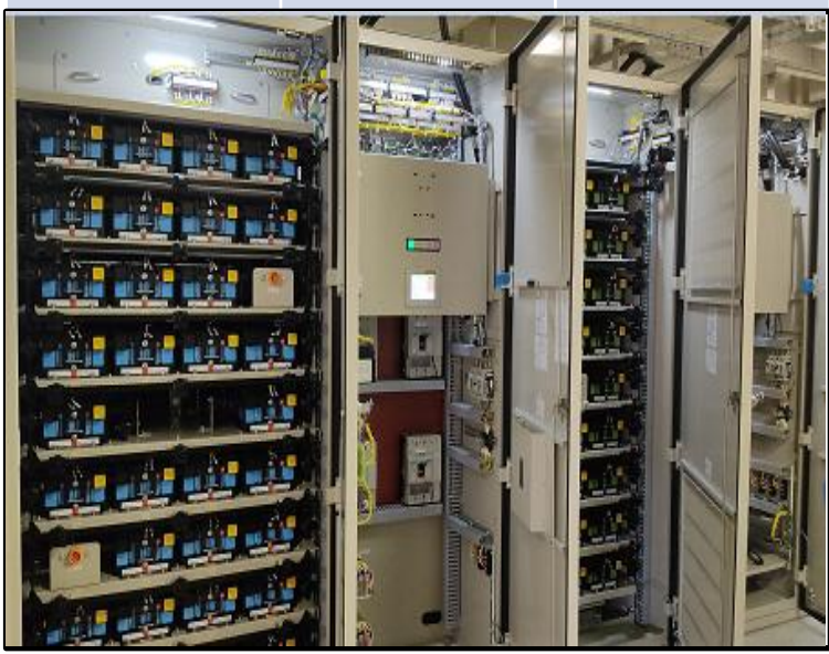
殿台変電所:回生電力貯蔵装置
