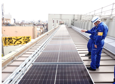
千葉公園駅再生可能エネルギー設備
