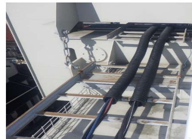
高圧配電線 (千城台北駅～千城台駅)
