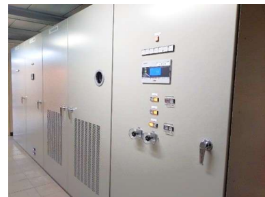
受配電設備 (スポーツセンター駅・動物公園駅)
