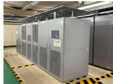
ATC/TD装置用電源装置 (千葉みなと駅)
