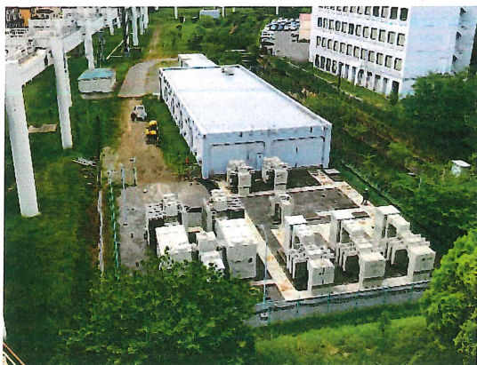
写真 殿台変電所
