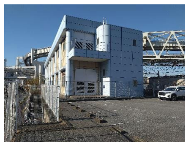
千葉変電所構内巡視
