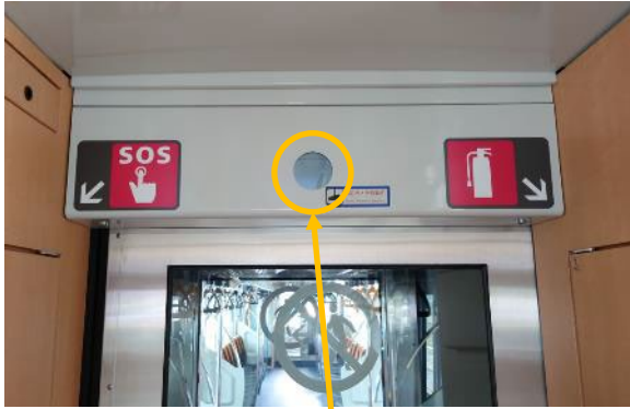
車内防犯カメラ (連結部側)
