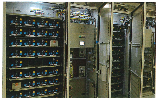
図IV-6. 回生電力貯蔵装置
