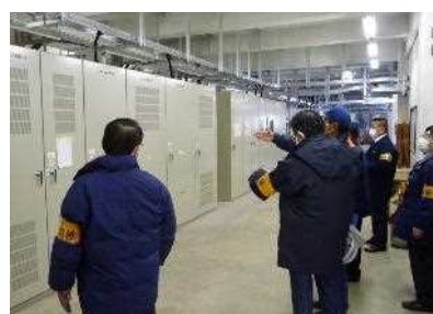
年末年始輸送安全総点検（殿台変電所）
