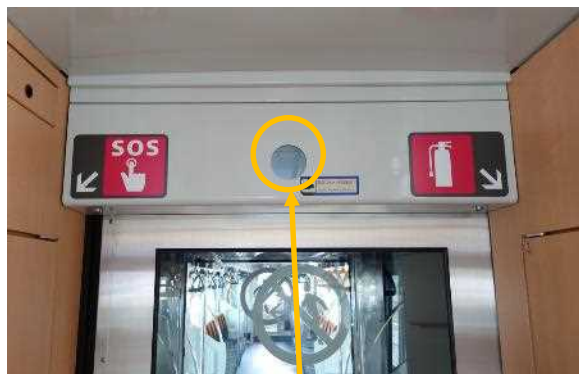
車内防犯カメラ (連結部側)
