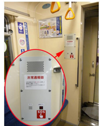
非常通報装置（客室内）
