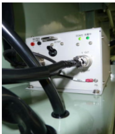
防護無線機電源(二重化改造)
