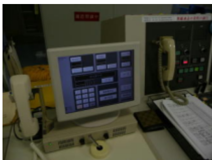
デジタル列車無線地上装置（運輸指令所）
