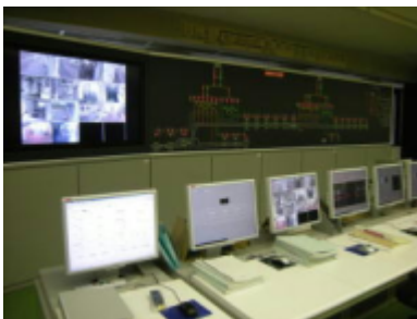
電力管理システム指令監視盤
